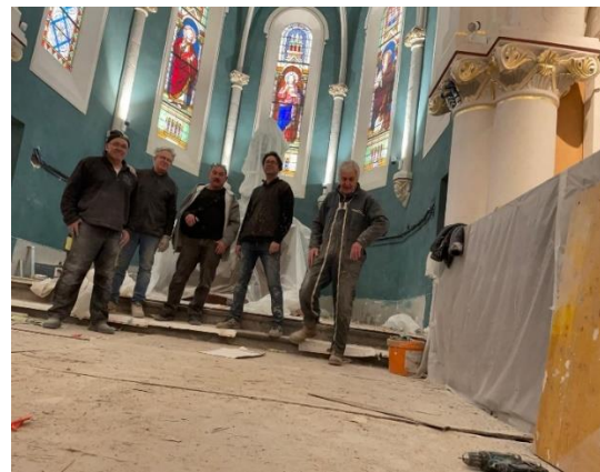
L'équipe de démontage des échafaudages savoure la dépose de la dernière armature.
